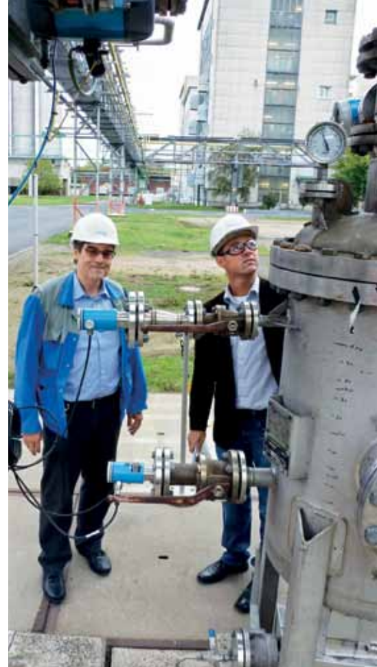
01 Thomas Moog und Martin Goray (rechts) am Abscheidebehälter mit der Füllstandmessung, bestehend aus den zwei Sensoren am Behälter sowie dem Transmitter
