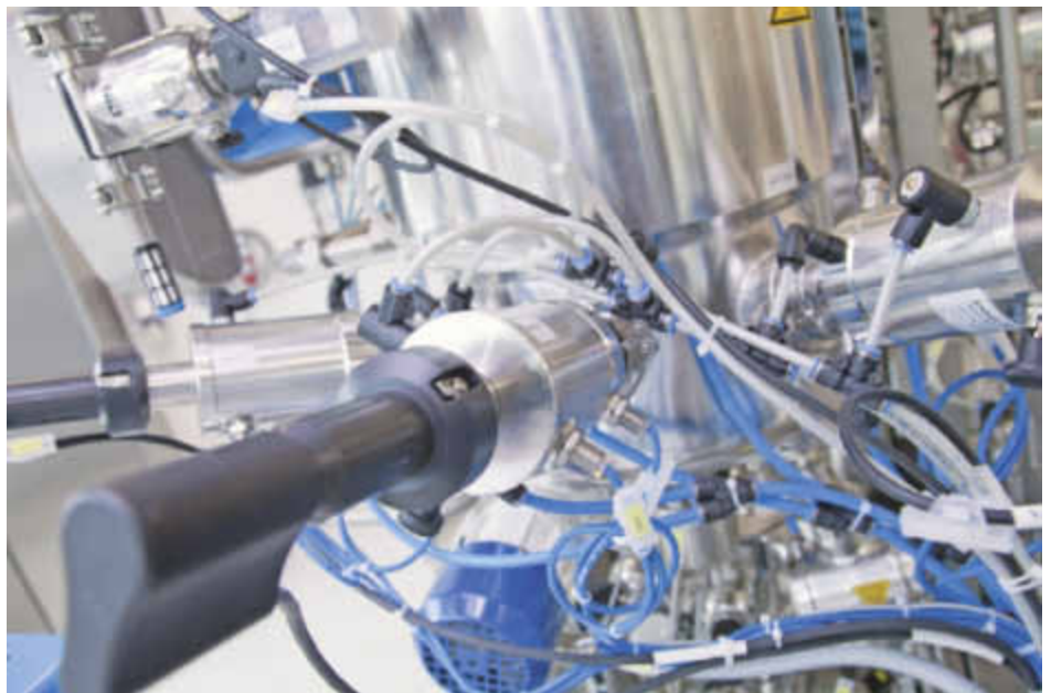
Bild 1: In biotechnischen Anlagen werden eine Vielzahl von Parametern bestimmt. Armaturen CPA475 zur vollautomatischen Messung, Reinigung und Kalibrierung von Analyseparametern erleichtern den Arbeitsprozess.
