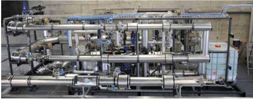
03 Endress+Hauser-Dampfprüfstand zur Erforschung von Einflüssen auf die Messtechnik und Entwicklung neuer Gerätefunktionen
