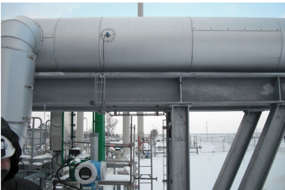
Bild 1. Durchflussmessungen im Warmwassersystem mit dem Ultraschall-Clamp-on-System PROSONIC FLOW. © Bild: Gascade Gastransport GmbH
