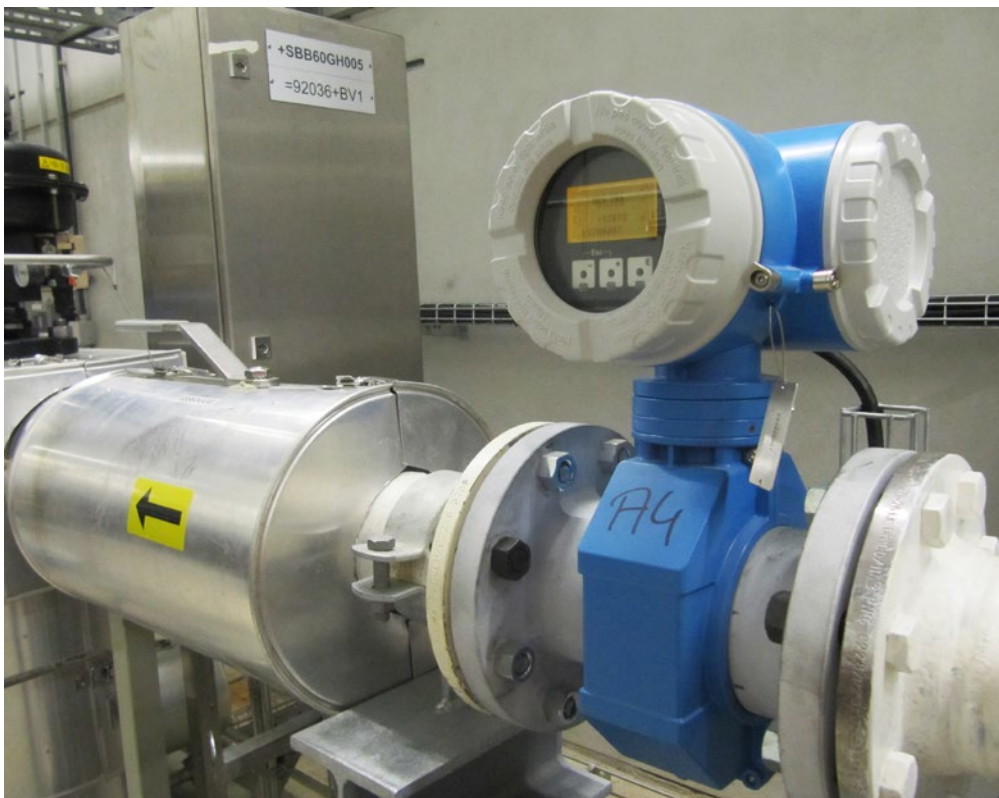
Bild 4. Hochgenaue Energiemengenmessung mit magnetisch-induktivem Durchflussmessgerät PROMAG. © Bild: Gascade Gastransport GmbH
