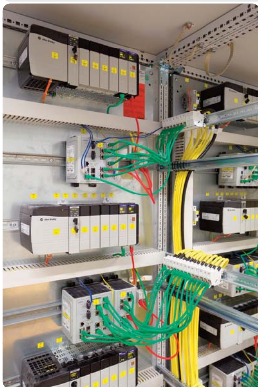
Bild 1: Im Schaltschrank laufen die Ethernet-Stränge zusammen
