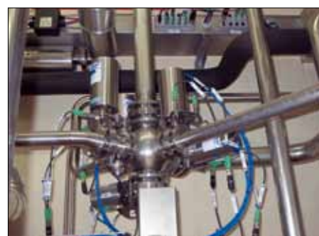
Der Schlüssel zur Lösung der Platzprobleme: die Ventile im „Verteil-Igel“ leiten die CIP-Medien auf engstem Raum in die Reinigungsreise (Bild: Mars)
