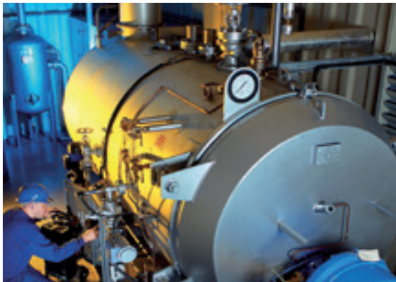
03 Kesseleffizienzüberwachung mit dem Memograph M RSG40
