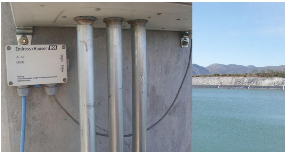
Waterpilot in Mexiko: Der Anschlusskasten sorgt für eine direkte und sichere Anbindung der Pegelsonde an das Leitsystem.
