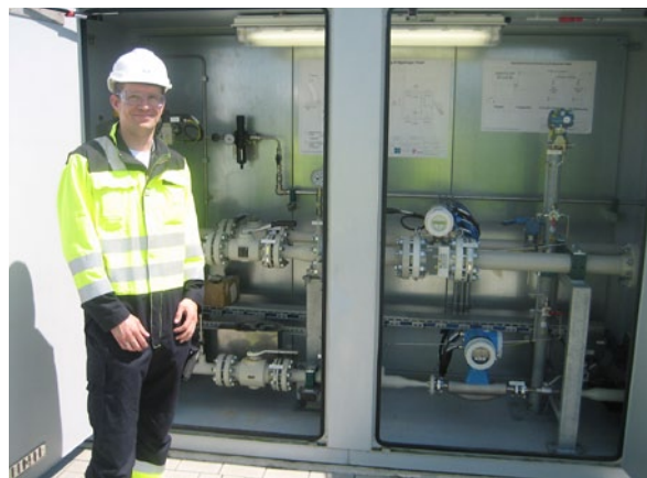
Bild 2. Michael Mollenhauer, Leiter EMSR-Technik bei STATOIL, am Erdgasspeicher Etzel Gas-Lager in Ostfriesland vertraut bei der eichamtlichen Erdgasmessung auf die Zuverlässigkeit und hochgenaue Messung mit Proline Promass.
