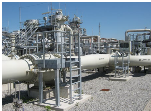
Bild 3. Erdgasspeicher Etzel Gas-Lager in Ostfriesland.
