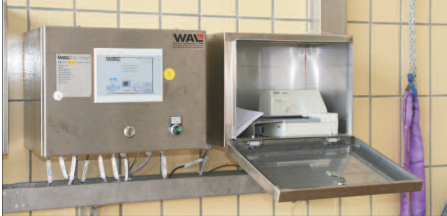
Steuerschrank (innen Auswertegerät und Steuerungsmodul) und Urbelegdrucker: Datenaustausch mit dem bestehenden Leitsystem geschieht über PROFIBUS DP-Kopplung.
