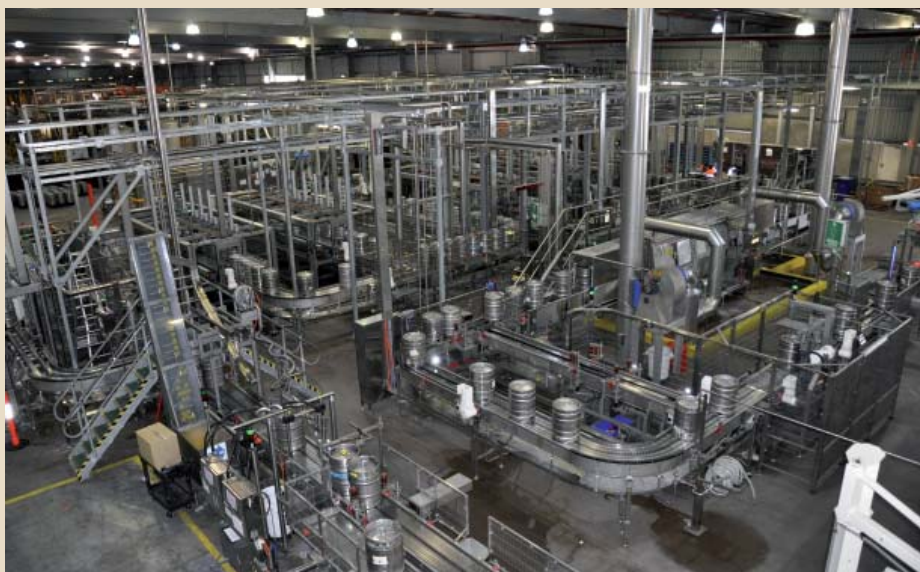
Promag 53H mit Ethernet/IP-Anbindung in der Bierfassabfüllung: Datenzugriff von allen Ebenen der Automatisierung erlaubt Prozessoptimierung Foto: Comac
