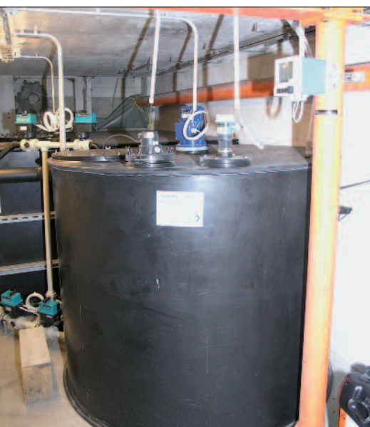
Abb. 4: Kompakte, vollautomatische Neutralisationsanlage mit zwei Behältern der Brauerei Unser Bier Basel
