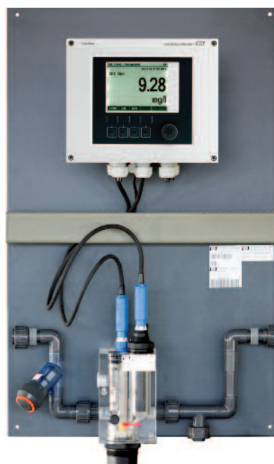
Abb. 3: Chlormessung CCS 141 in Bypassarmatur mit Transmitter CM 442 zur schnellen Justage des Chlorgehaltes
