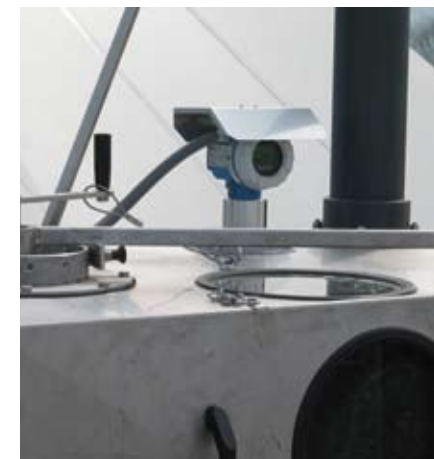
Kontinuierliche Füllstandmessung im Fermenter mit Radar: Micropilot M
