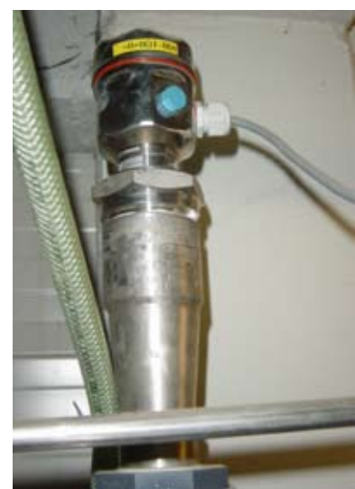
Druckmessung Biogasleitung: Cerabar
