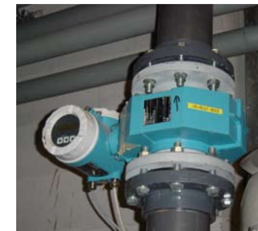
Mengenmessung des Eintrages: Promag 50W
