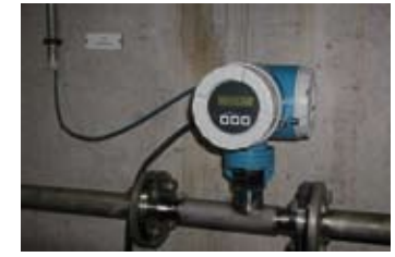
Biogasmessung: t-mass AT65 im Zulauf zum BHKW
