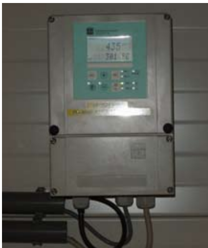
pH Messung in der Beschickungsleitung zum Fermenter: Transmitter Liquisys M CPM253
