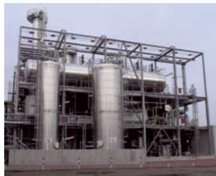
Eine von Endress+Hauser ausgerüstete Produktionsanlage
